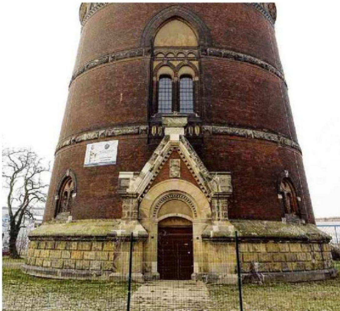
Die Fenster über dem Eingangsportal und der Fensterschmuck sollen ausgebessert werden.
