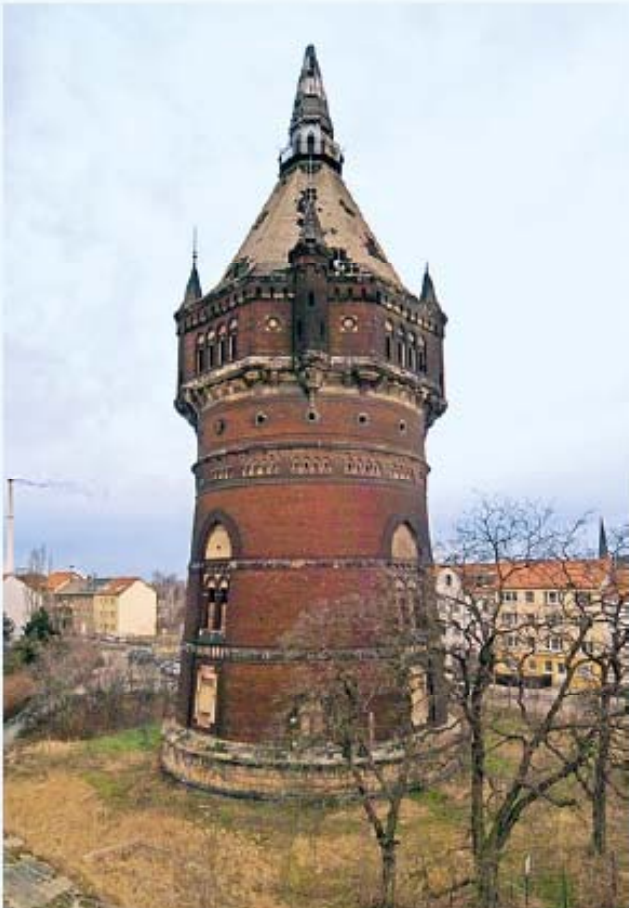
Der Neue Wasserturm vor der Dachsanierung (2007).
